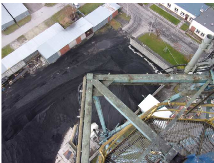
Fot.16.Zwieńczenie wieży kratowej, uszkodzenia korozyjne wieży kratowej
