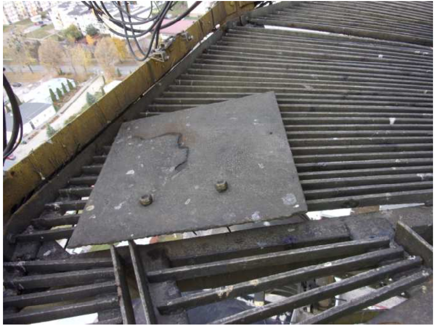
Fot.23.Zaawansowane uszkodzenia powłok malarskich pomostu szczytowego, odspojona kłapa włazowa
