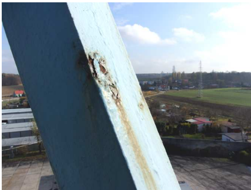
Fot.11. Uszkodzenia korozyjne wieży kratowej
