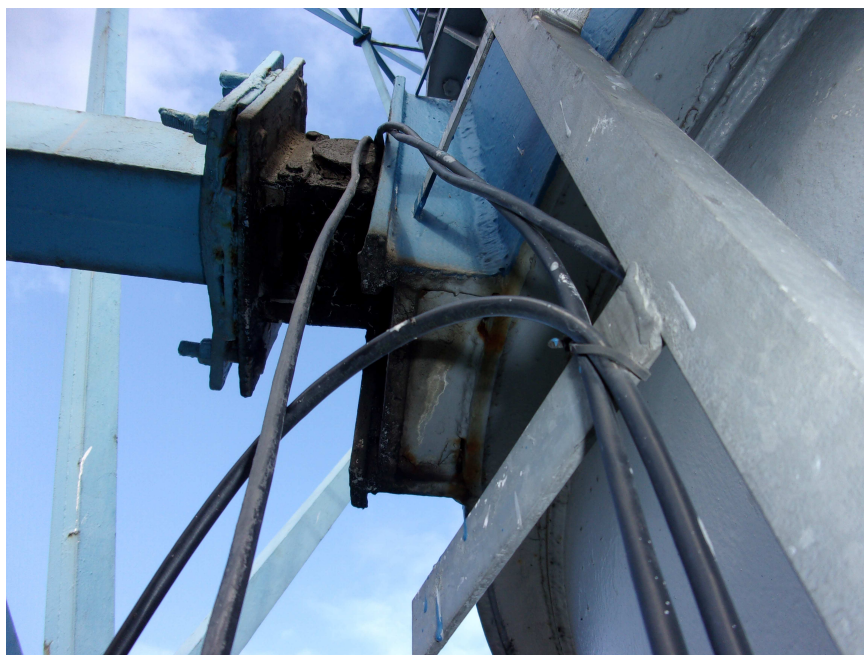
Fot.29.Odspojone kable anten sieci KPSI, oplatające podpore rolkową
