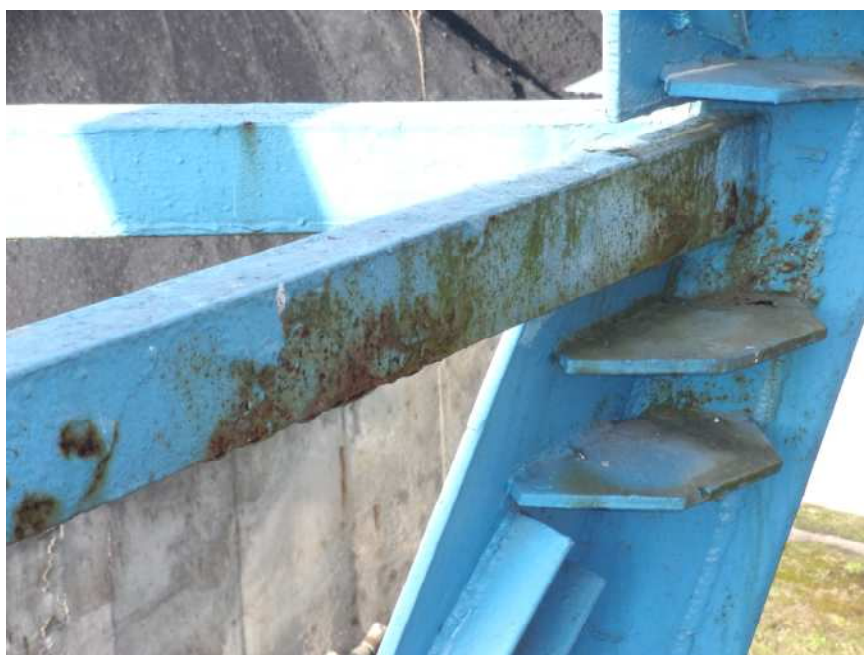
Fot.12. Uszkodzenia korozyjne wieży kratowej
