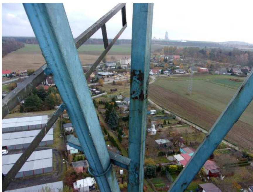
Fot.14. Uszkodzenia korozyjne wieży kratowej
