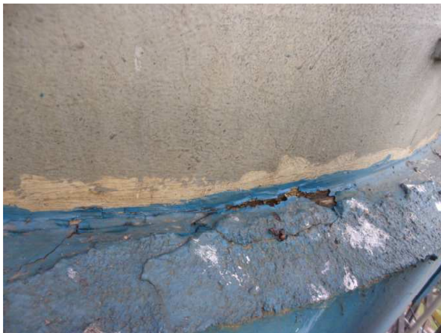
Fot.19. Uszkodzenia wypełnień na górnych powierzchniach pierścieni wzmacniających trzonu w poziomie podpór
