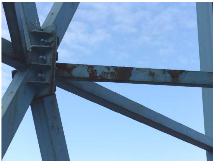
Fot.13. Uszkodzenia korozyjne wieży kratowej
