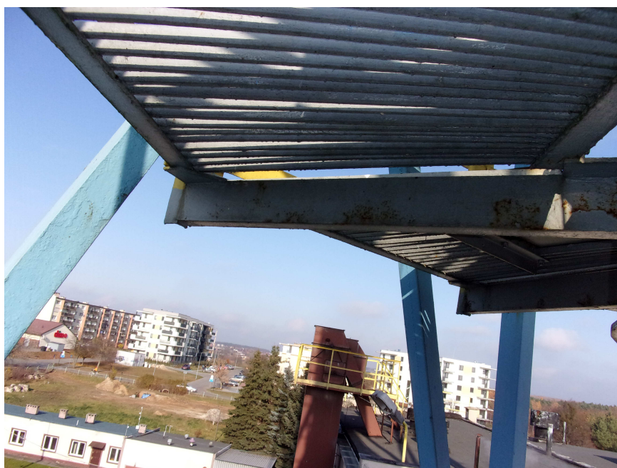
Fot.20. Uszkodzenia korozyjne pomostów
