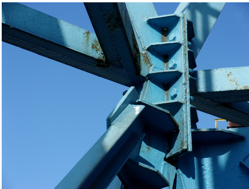
Fot.9.Uszkodzenia korozyjne wieży kratowej
