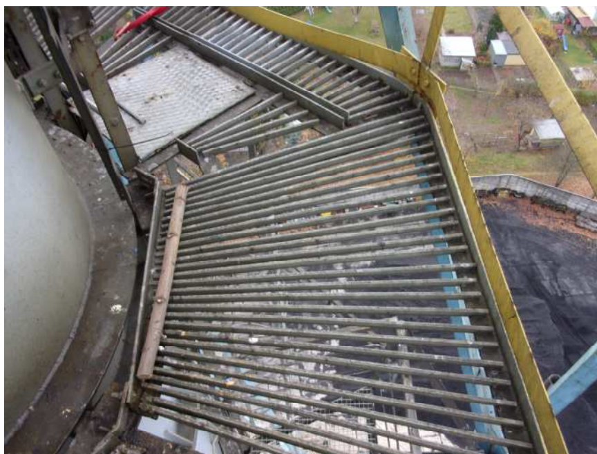
Fot.21. Uszkodzenia korozyjne pomostów, zapieczone zawiasy kłapy włazowej
