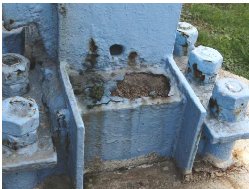
Fot.4.Zakotwienie gałęzi wieży kratowej w fundamencie , uszkodzenia wypełnień i powłok malarskich
