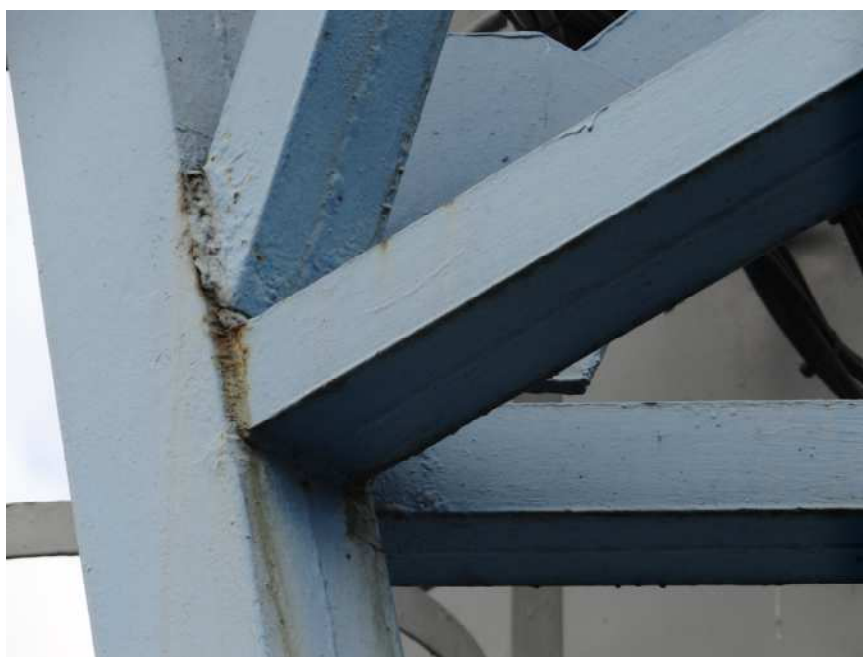
Fot.8.Uszkodzenia korozyjne wieży kratowej
