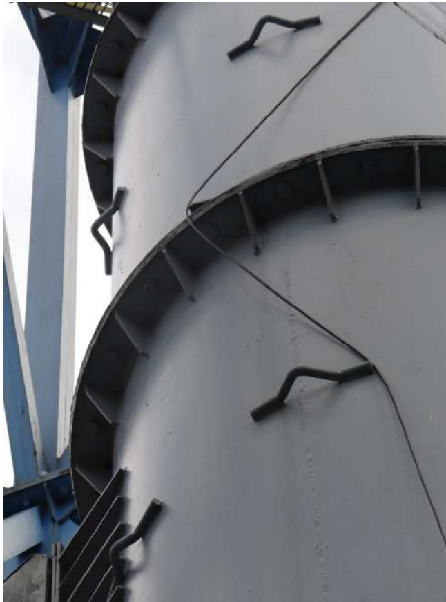
Fot.27.Odspojone kable anten sieci KPSI
