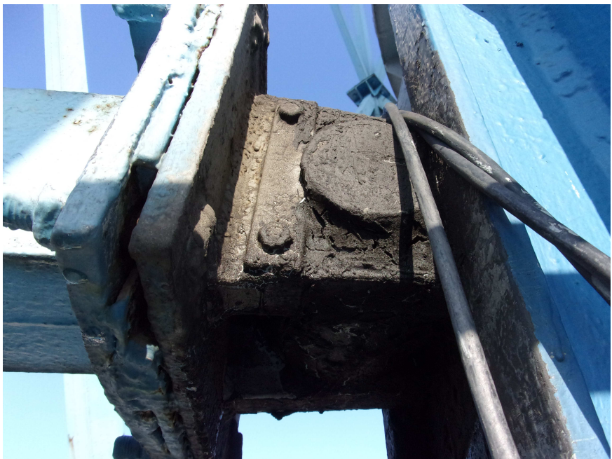
Fot.28.Odspojone kable anten sieci KPSI, oplatające podporeę rolkową
