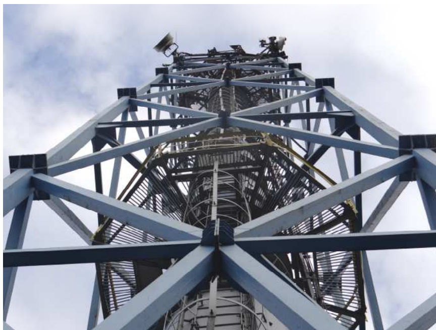
Fot.5.Konstrukcja przestrzenna wieży kratowej
