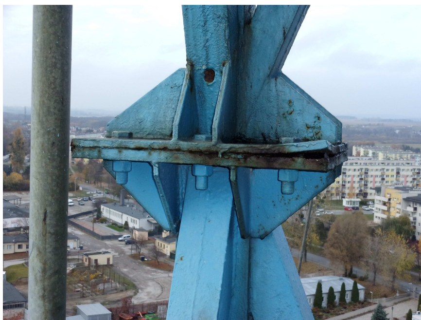
Fot.10.Uszkodzenia korozyjne wieży kratowej
