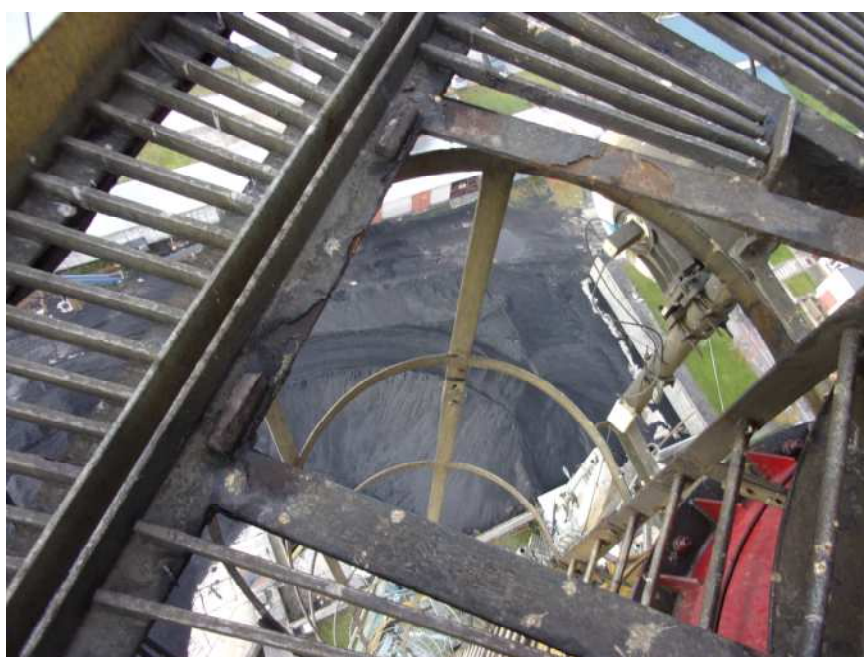
Fot.22. Zaawansowane uszkodzenia powłok malarskich pomostu szczytowego, odspojona kłapa włazowa
