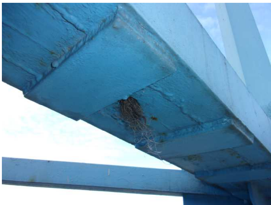
Fot.15.Pręt podporowy podpierający trzon w wieży, niedrożny otwór odwadniający
