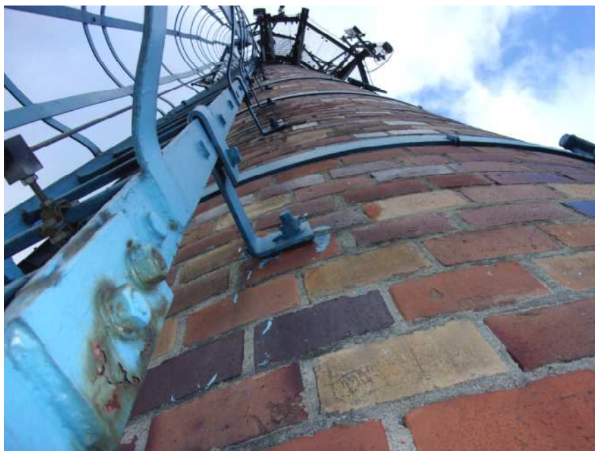
Fot.13. Lokalne uszkodzenia powłok malarskich drabin
