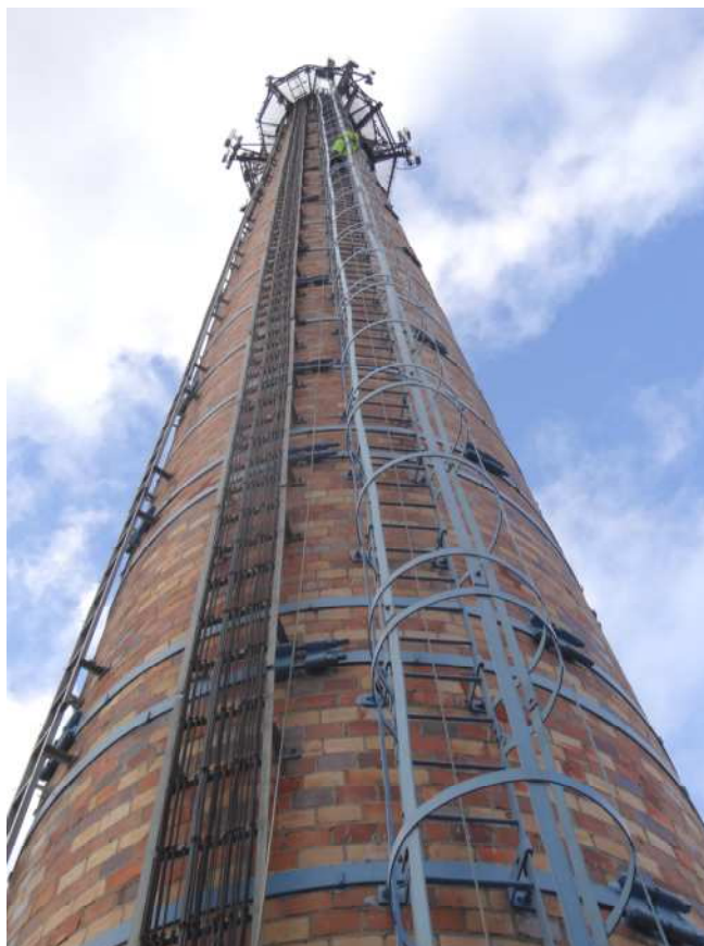
Fot.9.Ciąg drabin włazowych z koszem osłonowym
