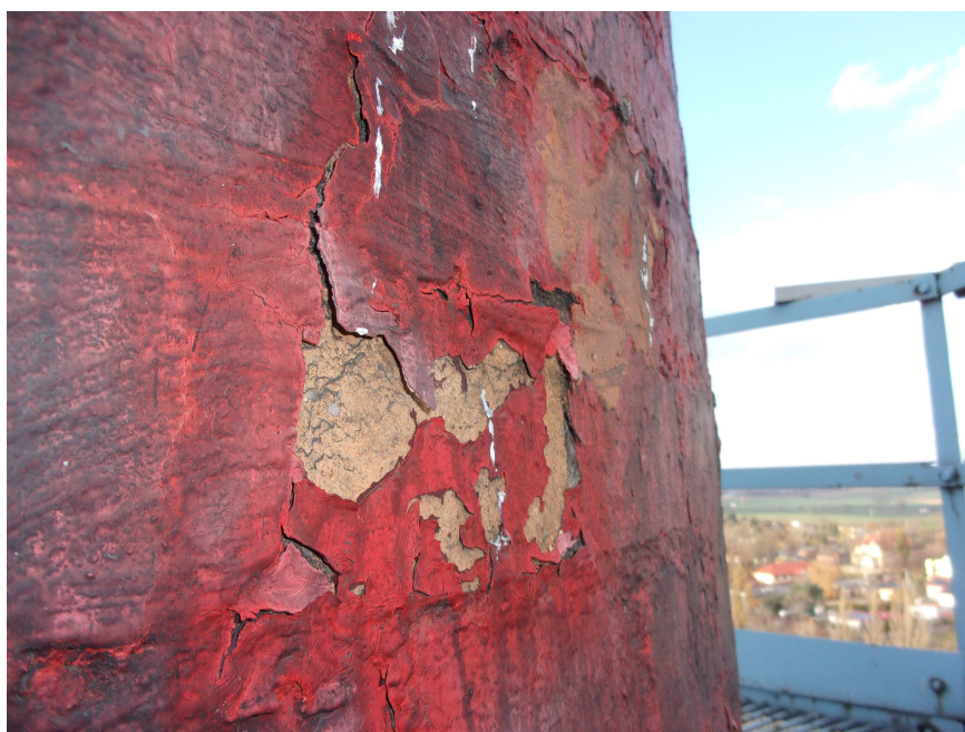
Fot.17.Zwężka ceramiczna na szczycie komina, lokalne uszkodzenia
