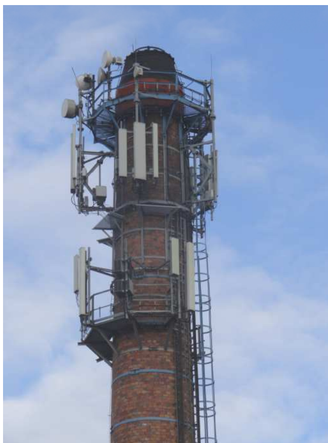
Fot.2.Anteny sieci T-Mobile (poniżej) i PLUS (powyżej) zawieszane na szczycie komina, wprowadzone dodatkowe podesty obsługowe anten
