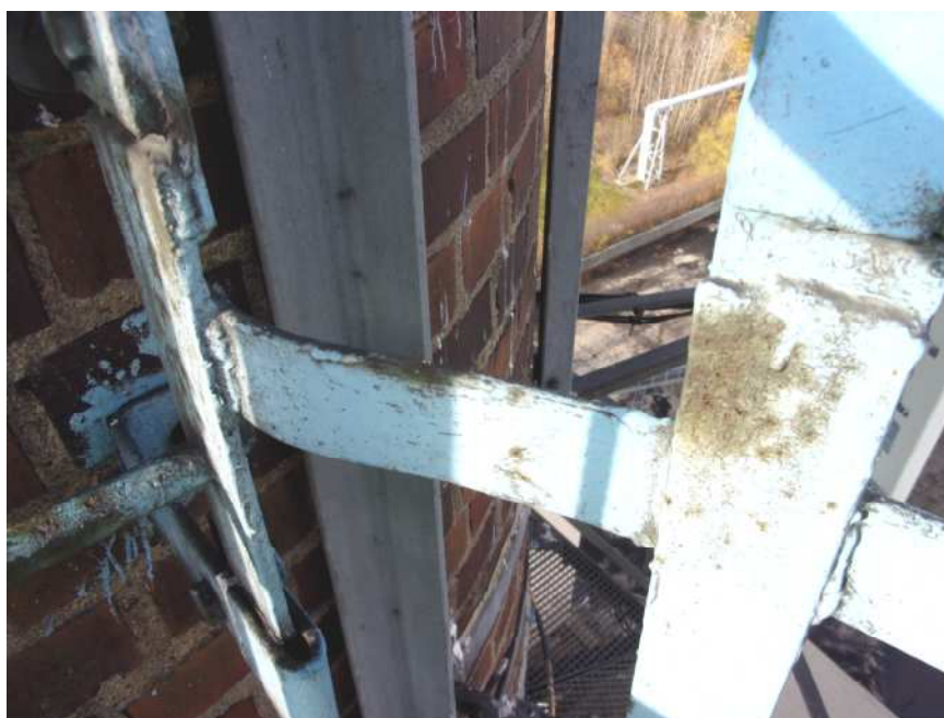
Fot.14. Lokalne uszkodzenia powłok malarskich drabin
