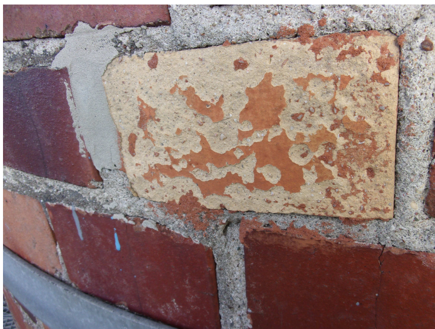
Fot.7. Lokalne ubytki licowych warstw cegieł
