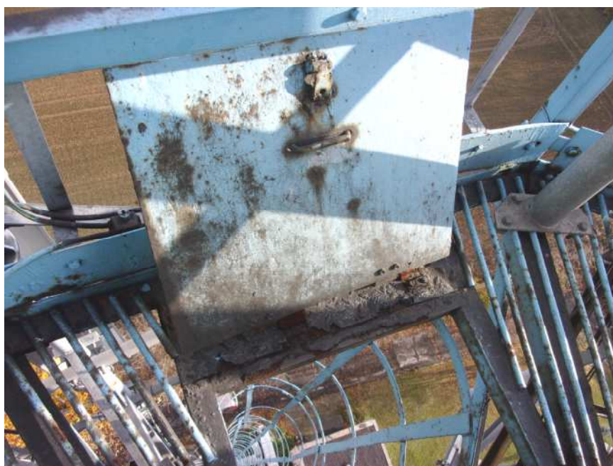
Fot.12. Uszkodzenia korozyjne szczytowego pomostu obsługowego
