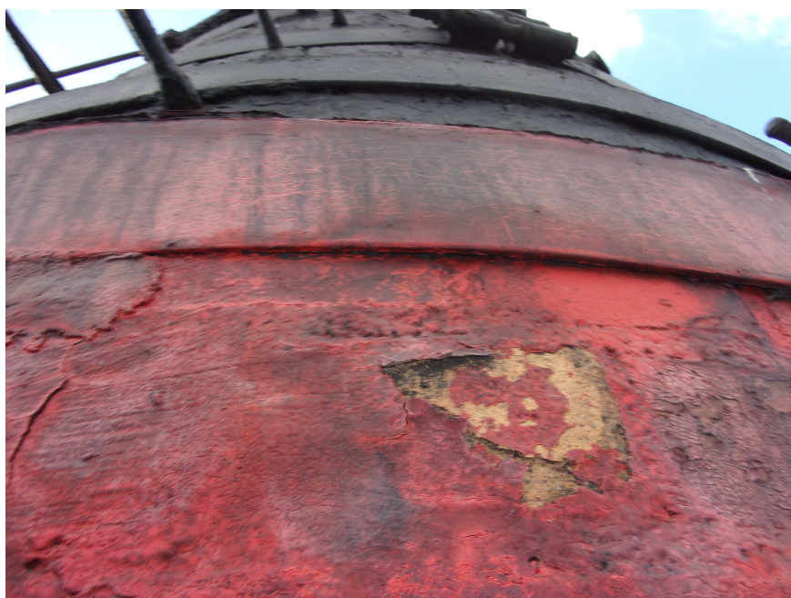
Fot.16.Zwężka ceramiczna na szczycie komina, lokalne uszkodzenia
