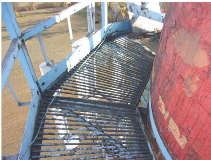
Fot.11. Uszkodzenia korozyjne szczytowego pomostu obsługowego
